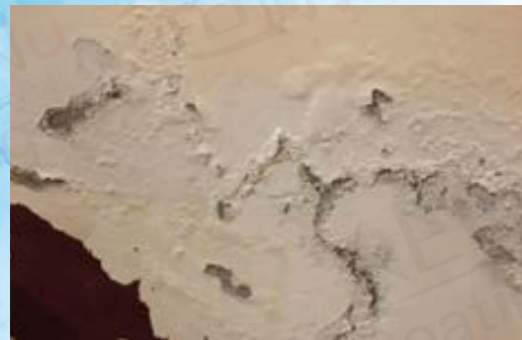
牆壁裂縫滲水，牆內鋼筋生鏽流出鏽水，影響居住安全。
